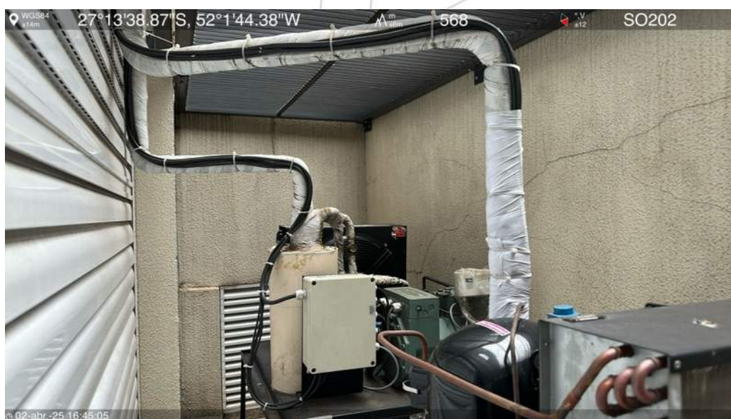
Central de refrigeração (externo)
